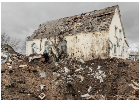
Peu avant Noël, la maison de prière de Solotchiw a été fortement endommagée par l'onde de choc d'une bombe planante.
